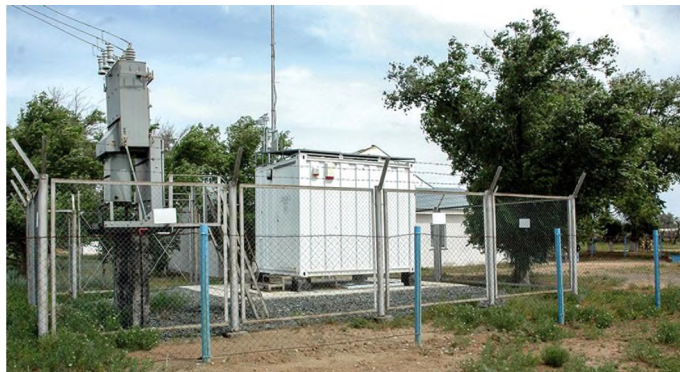
Рисунок 1. Станция мониторинга качества воздуха компании NCOC
