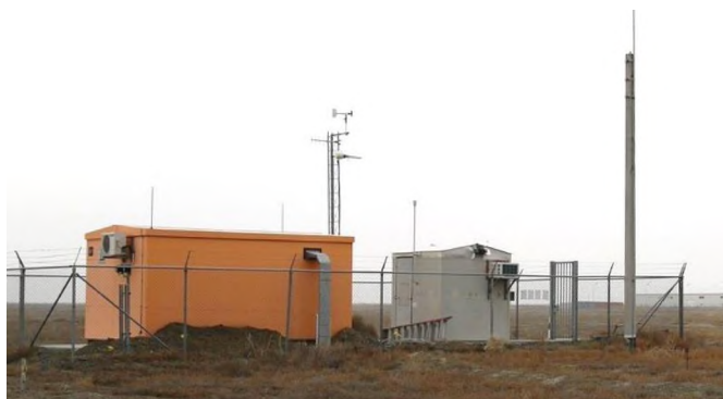
Рисунок 2. Станция наблюдения за окружающей средой ТОО «Тенгизшевройл»
